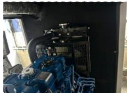
ESTADO DEL MOTOR
