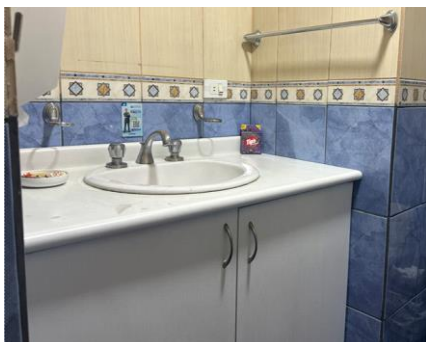
LAVAMANOS BAÑO PLANTA BAJA
