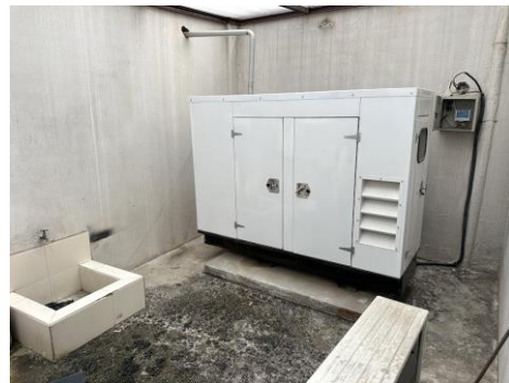
CUARTO DE GENERACIÓN
