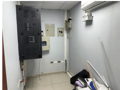
CUARTO DE CONTROL ELÉCTRICO
